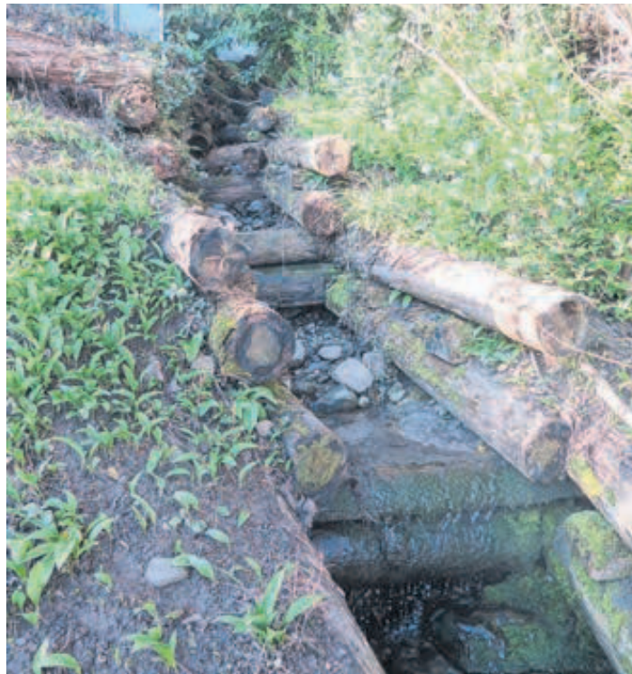
In diesem Bachbett sind Schäden zu sehen, die noch mit regulärem Unterhalt in Ordnung gebracht werden können. Vierterorts in den Höfen sind jedoch grössere Arbeiten nötig.
